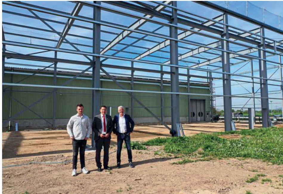
Ortstermin: Tim Hodapp, Juniorchef Firma Hodapp, Bundestagsabgeordneter Johannes Fechner und Firmenchef Peter Hodapp (von links) vor der Stahlkonstruktion Foto: R. Brunner
