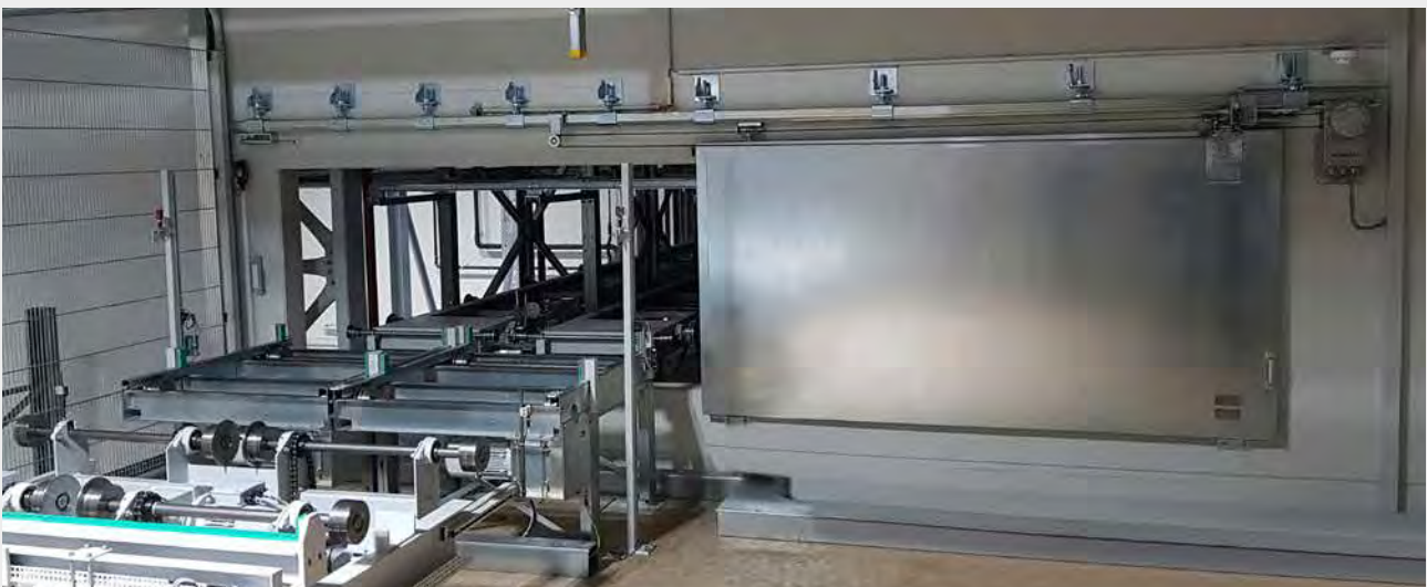
Abschottung eines Hochregallagers
